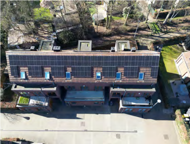
Foto: Dronebeeld zonnepanelen Lijsterplein Vorseelaar (februari 2023)
